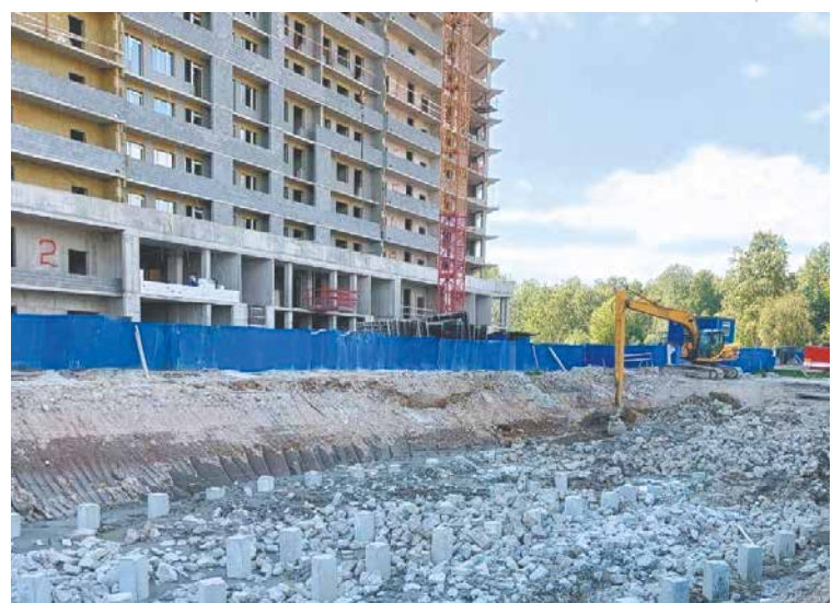
Подрядчики строительства здания полиции на Европейском проспекте в Кудрово закончили погружение свай в свайное поле
